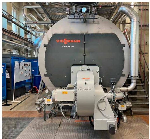
La chaudière à vapeur 8 t/h avec brûleur bicombustible mazout/gaz, avec combustion combinée automatique de biogaz à partir des deux combustibles (pression de vapeur: 14 bar).
