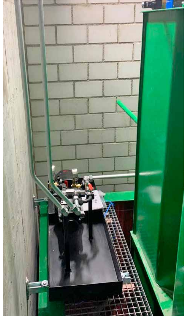
La pompe à haute pression du brûleur de la chaudière de récupération pour la postcombustion.
