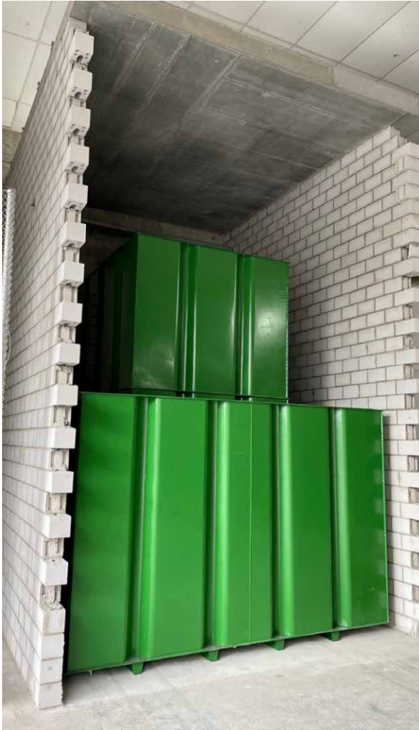
Le nouveau réservoir de mazout cubique (avec bac de rétention) en acier peut contenir 13'000 litres.
